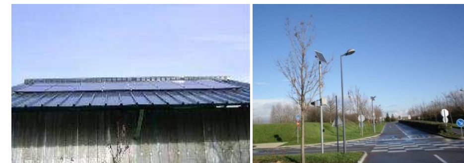
Figure 49 : Installation photovoltaïque à l'Est de Gien et éclairage public alimenté par panneaux photovoltaïques (Source : BDPV, SORELEC)
